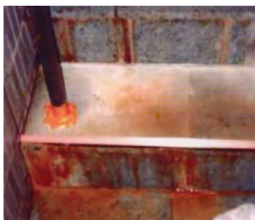
浴室内スケール
