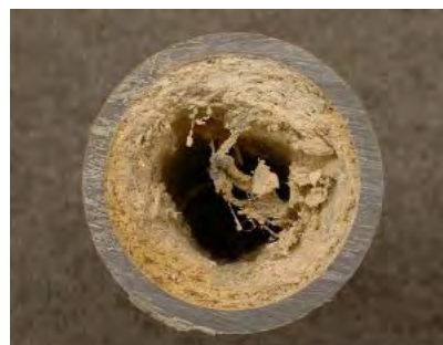
温泉配管内スケール (B)
